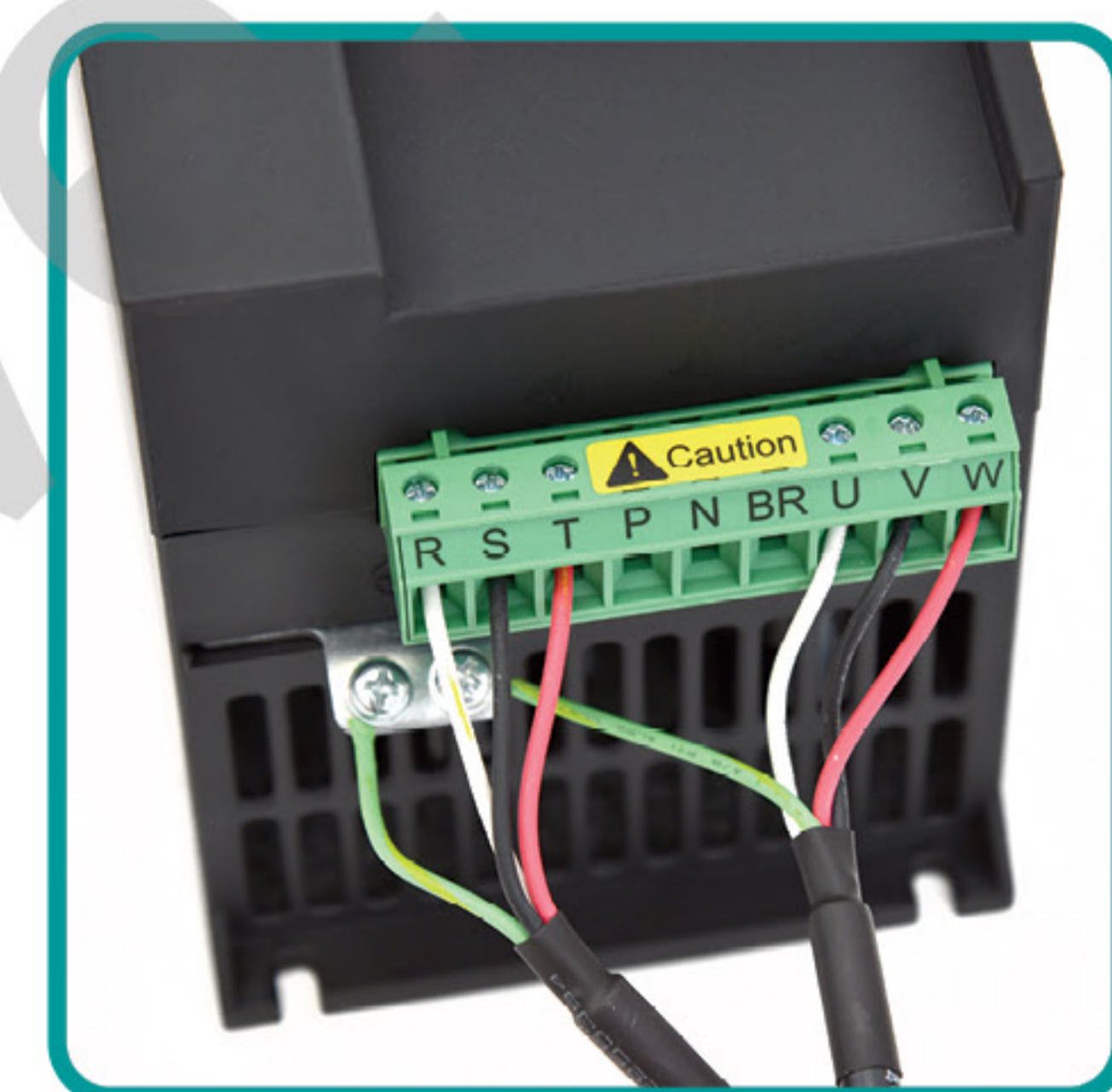
Подвод кабелей снизу
